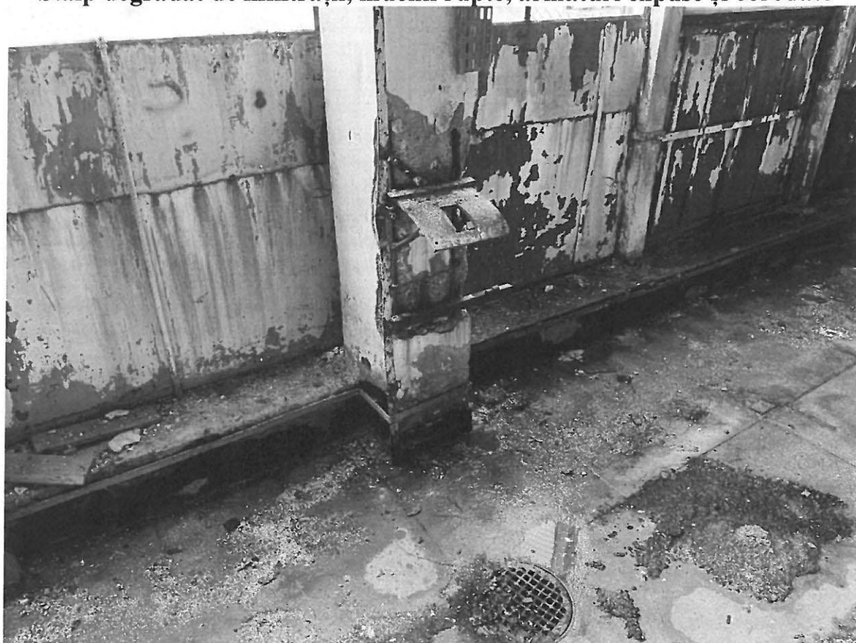
Stâlp degradat de infiltrații, muchii rupte, armături expuse și corodate
